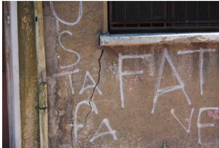
Un exemple de fissure profonde
